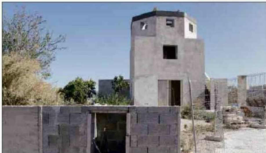
Las obras del Observatorio de Puig des Molins se pararon al quebrar la constructora. VICENT MARI
